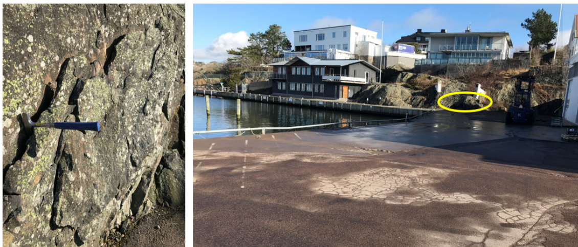
Figur 14. Löst skivigt berg i slänt D längs fastighetens östra gräns.
